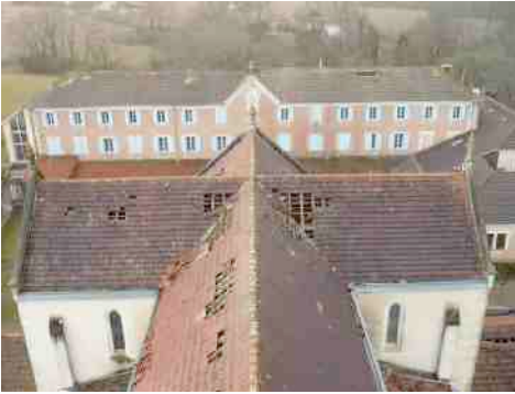
Dégâts sur les toits.
